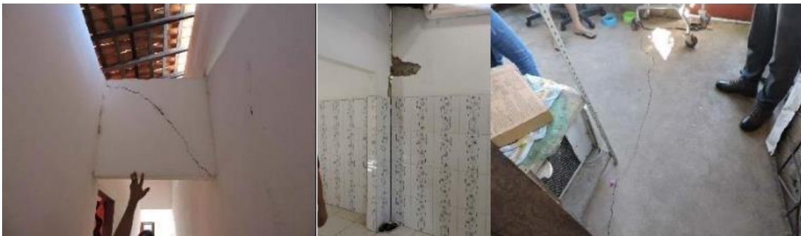
Figura 3 - Rachaduras. Fonte: Ribeiro (2018).
