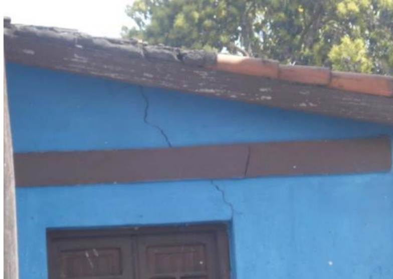
Figura 1 - Trinca em uma edificação situada a 10 metros de distância da linha férrea. Fonte: Brito, Kamimura e Santos (2015).
