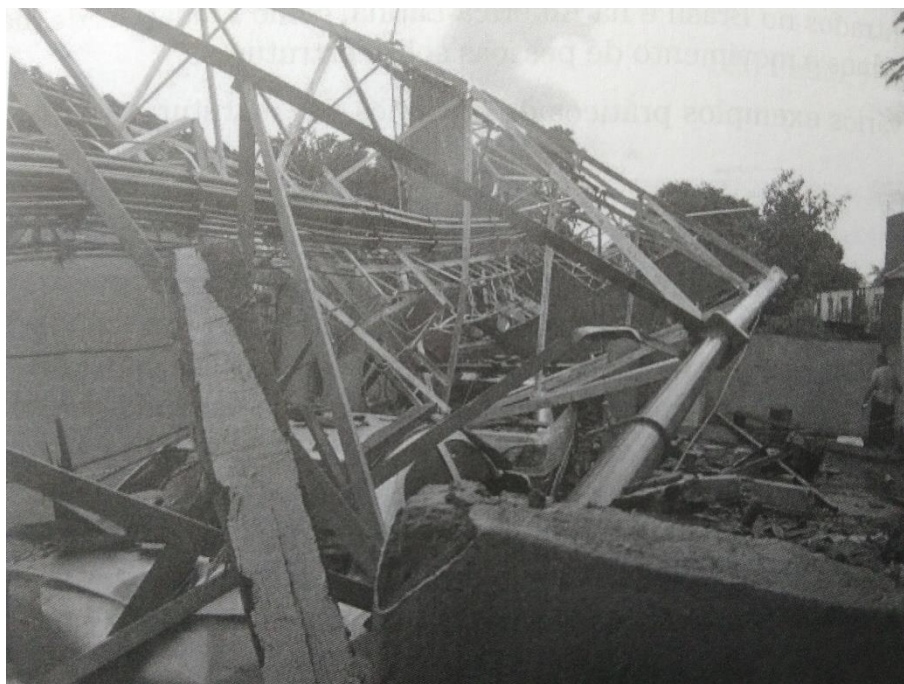
Figura 4 - Torre de telecomunicações que entrou em colapso sob a força do vento.
